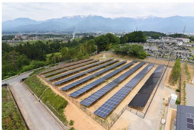
図表 56 リユース品を使用した発電所
